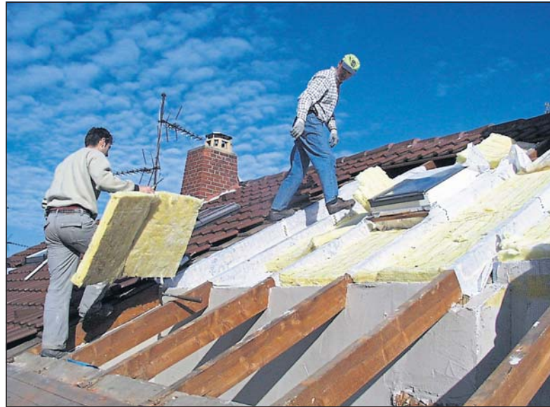
Wenn das Dach neu eingedeckt werden muss, ist es Zeit, die Dämmung zukunftsfähig zu machen. Spätestens jetzt muss sie den Anforderungen der Energieeinsparverordnung genügen. Hier: Zwischensparrendämmung aus Mineralwolle. (Foto: VZ RLP)
