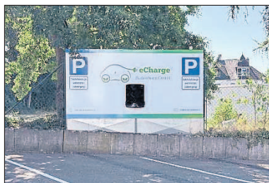
So sieht die neue Ladesäule aus.
